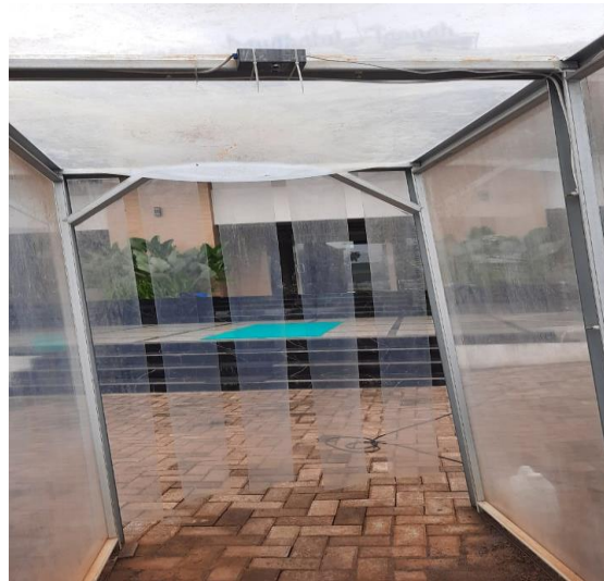
Gambar 5. Pemasangan alat penyemprot otomatis
